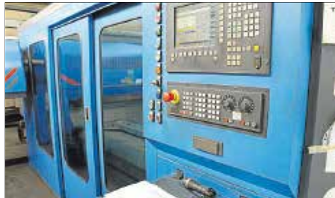
Dette er Effer-fabrikens nye laser-cutter. Herinde kan der skæres i stål på op til 20 mm i tykkelse. Skal der skæres i tykkere stål, foregår det på andre maskiner på fabrikken.
